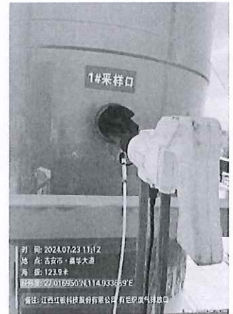
有组织废气排放口
