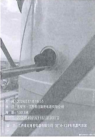
三厂 4-12# 有机废气排放口
